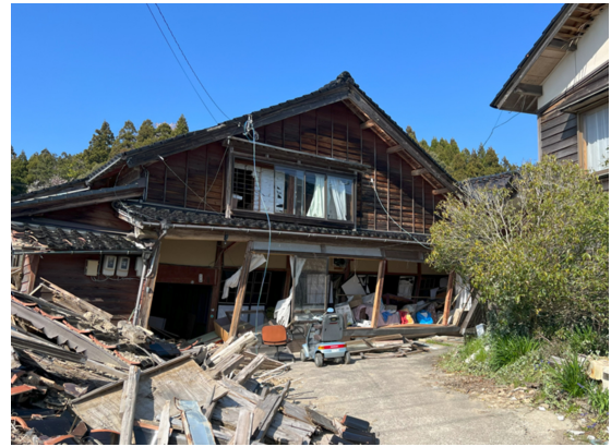
写真5 大きく傾斜した家屋(珠洲市蛸島)
