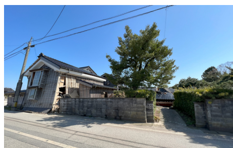
写真3 右奥の主屋が倒壊、左が土蔵が傾く（珠洲市正院）
