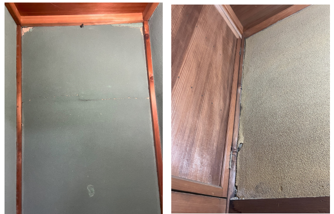
写真8 壁と柱等の一部の壁の剥落
